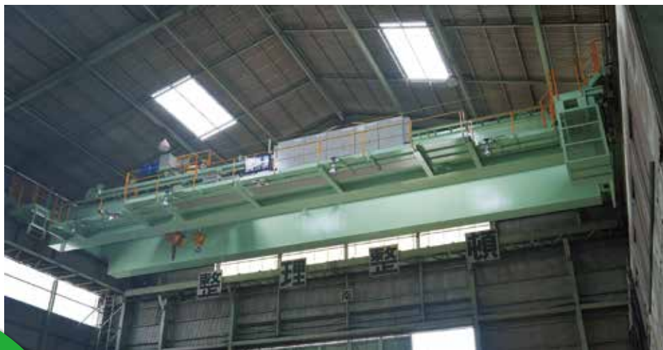
天井クレーン
